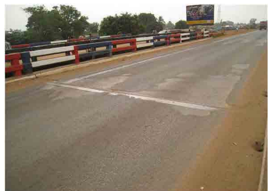
ダブル橋 既存道路側のダブル橋の状況である。 橋面の舗装が無く、コンクリート床版が露出して おり、補修及びメンテナンスが必要である。
