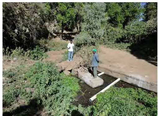
既存の水道施設（湧水保護）
