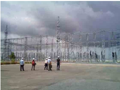
West Phnom Penh 変電所 (遮断器・断路器)
