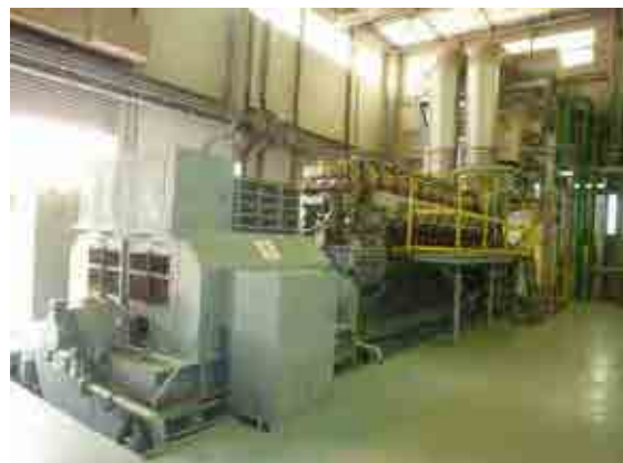
キングトム発電所 (7号機、8号機：Niigata製)
