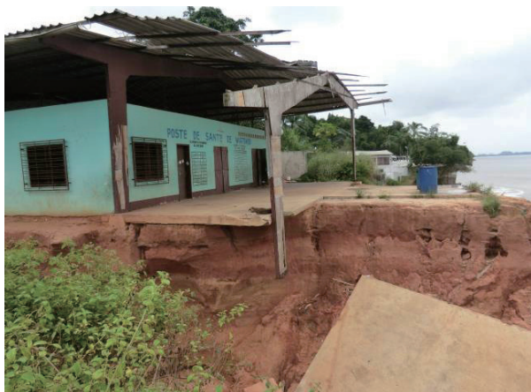
マトンビ：ポワント・ノワール市街から約 20km 北側に位置するが、海岸浸食による漁村施設の崩壊が見られる。
