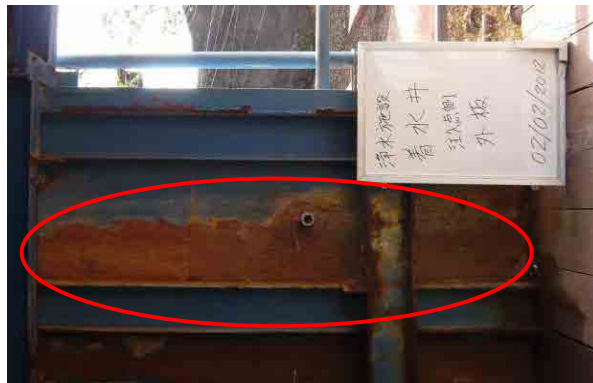
【着水井壁外面腐食状況】
