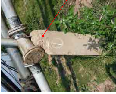
【受台①頂部コンクリート欠損状況】
