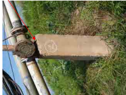
【受台②頂部コンクリート欠損状況】
