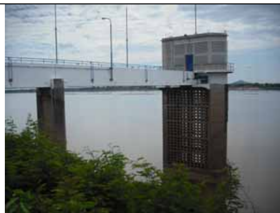
類似案件の状況 2：サバナセツト浄水場取水施設（日本の無償で改修された。）
