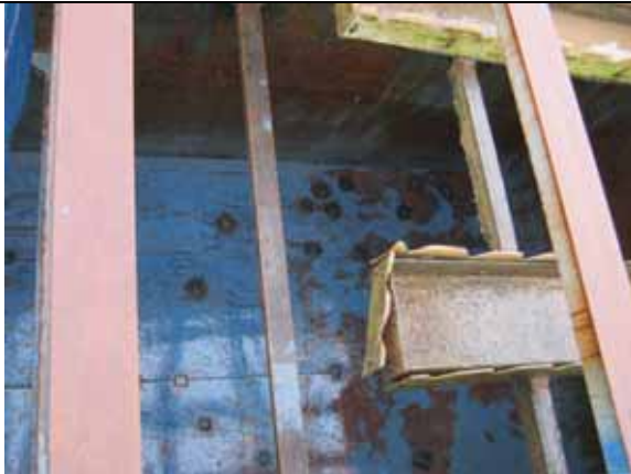
対象サイトの現状 5：タケク郡の既存浄水場(沈 殿池、空の状態)(沈殿池の底板や壁に溶接で補 修された跡が 30 ヶ所以上ある。)
