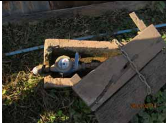
対象サイトの現状 6：既存の水道メータ (パイプ給水の行われている家にある水道 メータ。)
