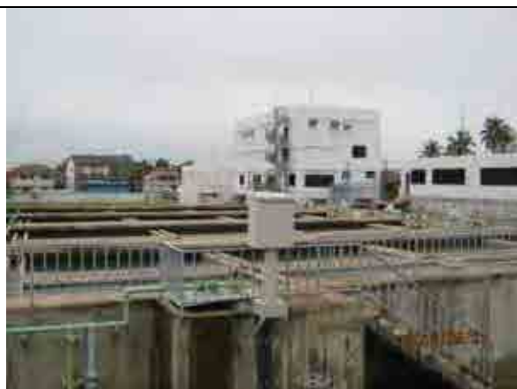
類似案件の状況 1：カオリオ浄水場（ヴィエンチャン特別市）
