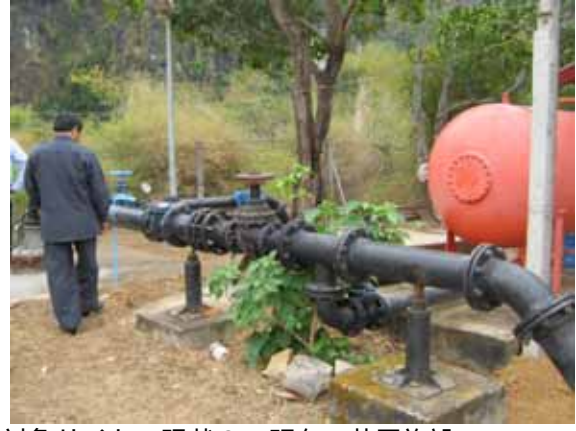
対象サイトの現状 2：既存の井戸施設 (No.1、No.2、No.3 があるが、No.3 は故障のため、現在は No.1 と No.2 で運転中。)
