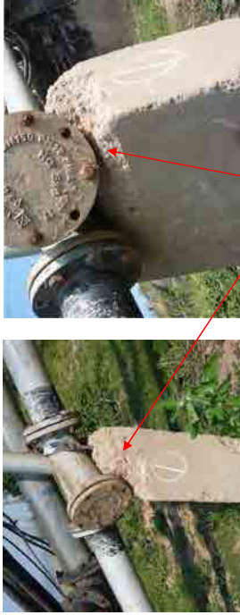
【受台①頂部コンクリート欠損状況】
