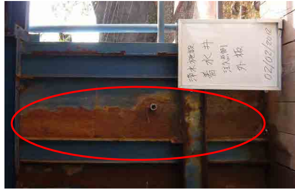
【着水井壁外面腐食状況】
