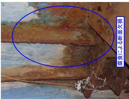
【2F～3Fフロック形成池側柱下部腐食状況】
