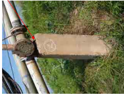
【受台②頂部コンクリート欠損状況】
