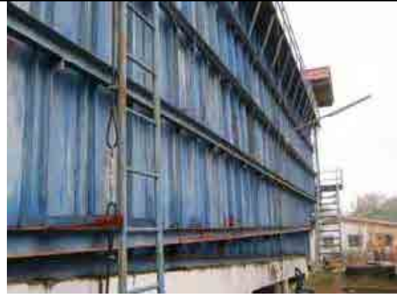
対象サイトの現状 4：タケク郡の既存浄水場側面 (水圧により壁が撓んできており、ワイヤーにて 押さえている。)
