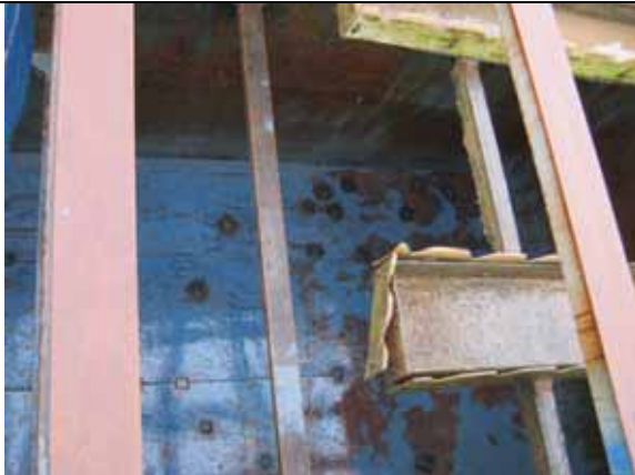
対象サイトの現状 5：タケク郡の既存浄水場(沈 殿池、空の状態)(沈殿池の底板や壁に溶接で補 修された跡が 30 ヶ所以上ある。)
