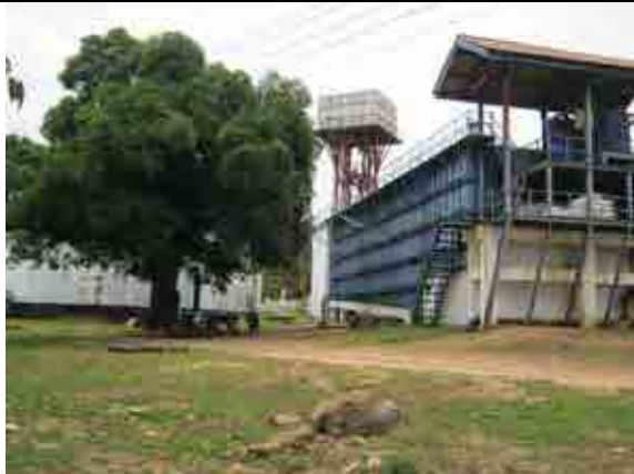
対象サイトの現状 3：タケク郡の既存浄水場 (浄水施設は腐食が著しく廃棄の方針を決めた。 左手の配水池は今後も使用可能。)
