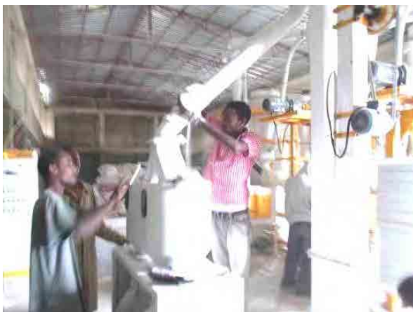
製粉機の調整作業
