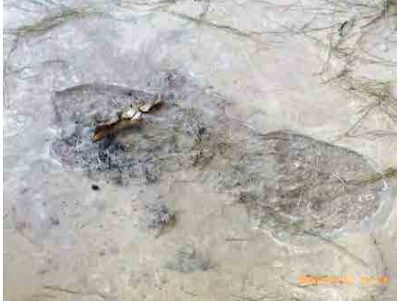
損傷した床モルタル仕上げ
