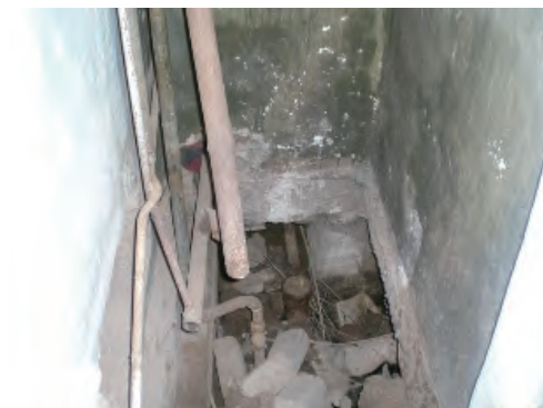
施設内の既存配管の一部。老朽化が進み、全く使用不能
