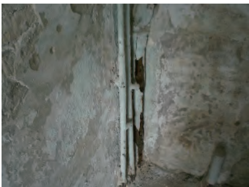
産科棟内の立て排水管。完全に腐食し、管内が露出している。
