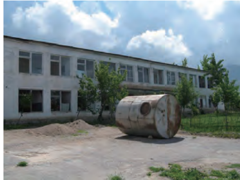
裏面外観。一部の窓にはガラスがない。
