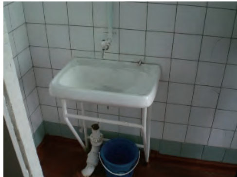
既存の陶製洗面器。給排水管とも使用不能
