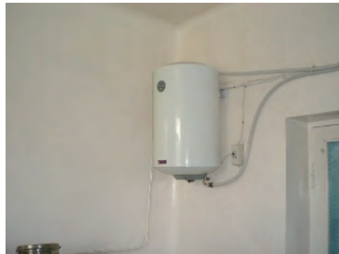
使用中の局所給湯器
