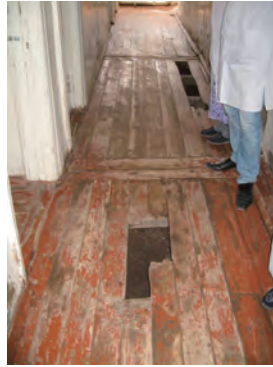
中廊下床。木製床の一部が欠落している。
