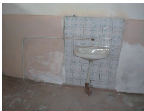
施設内部の洗面器。給排水配管は破損したままである。
