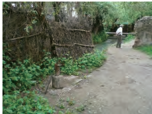
渇水期（冬季）に使用する井戸ポンプ
