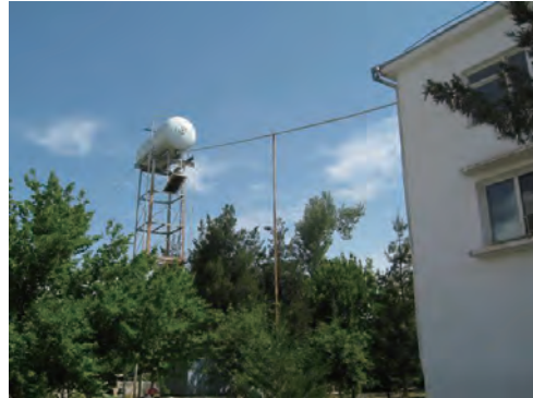
2008年 UNICEF の資金で建設された高架水槽。高架水槽から給水管で本館に給水
