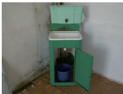
施設で使用されている手作り洗面台。給水は上部のタンクから引いている。
