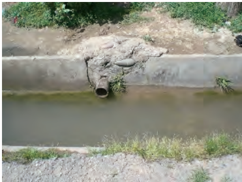
敷地側面道路沿いの用水路と施設内受水槽を結ぶ取水管
