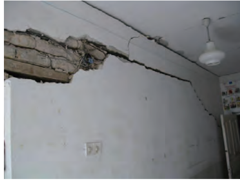
内部廊下の壁に地震による大きな亀裂が残っている。壁の撤去が必要
