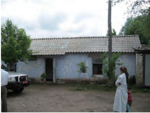
正面外観。1960年代に建設された小規模なMH。建物の老朽化が激しい。
