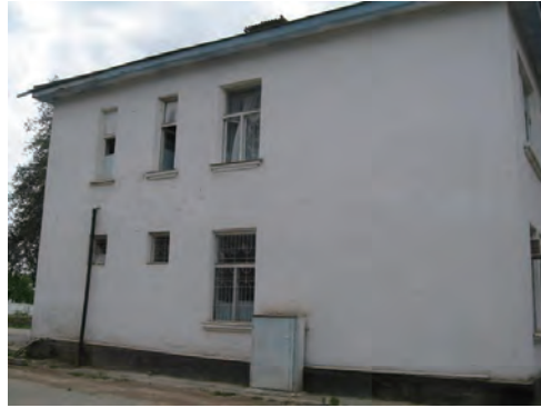
東側妻面。左側に見える黒いパイプは2階のトイレからの排水管。病院スタッフが設置した。
