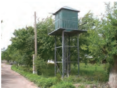
UNDP/USAID により設置された高架水槽
