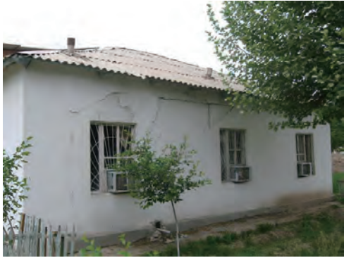
建物外観。外壁のプレキャストパネルに地震による目違いが見られる。
