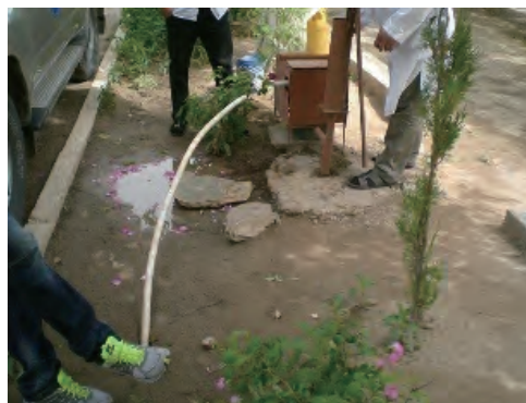
水源の井戸揚水ポンプ
