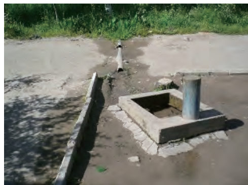
NGOにより構内に設置された共同水栓
