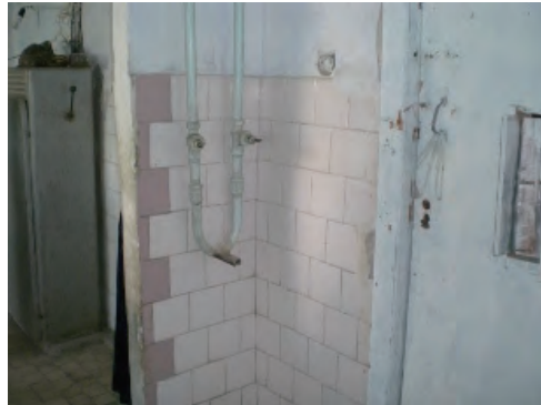
給水、給湯管の配管。使用不能
