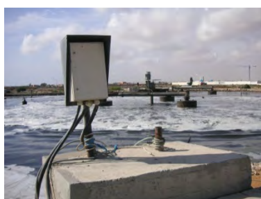
Photo 4-68 Boîte de jonction
