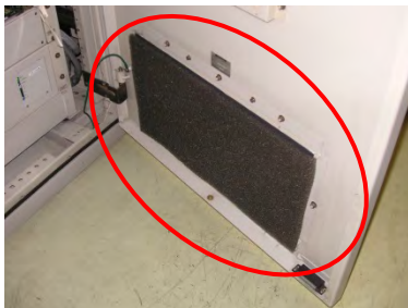
Photo 4-49 Exemple - Filtre d'air de reprise (Japon)
