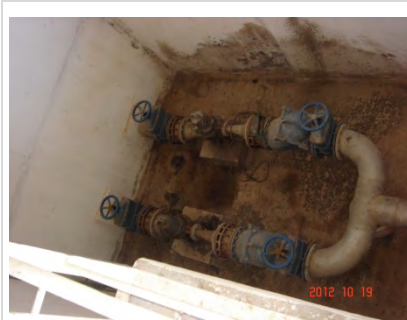
Photo 4-25 Pompe de boue en surplus
