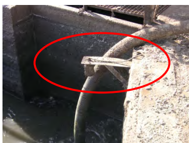
Photo 4-70 Immètre en amont de dégrilleur
