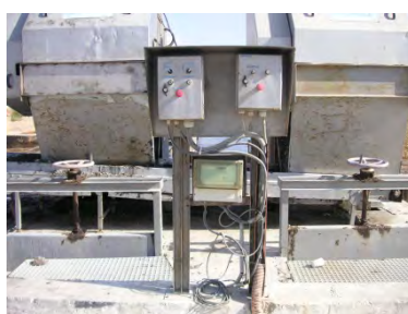
Photo 4-71 Tableau de commande de dégrilleur
