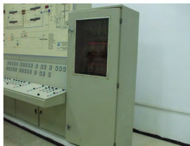
Photo 4-44 Panneau de surveillance automatique
