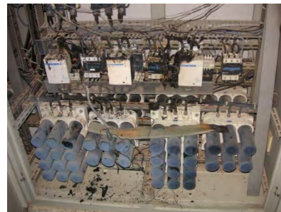
Photo 4-55 Tableau de condensateur
