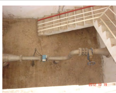
Photo 4-26 Tuyau de refoulement
