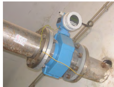
Photo 4-66 Débitmètre de boue d'alimentation de sécheur (Vue agrandie)
