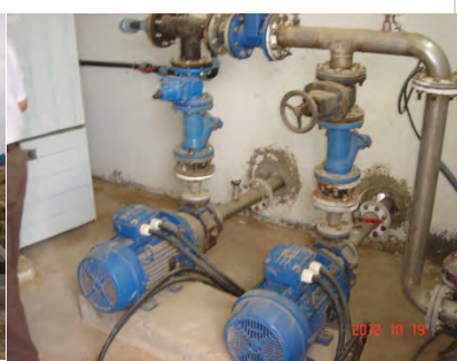
Photo 4-41 Pompe d'eau d'usine
