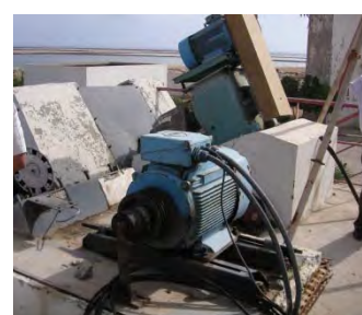
Photo 4-72 Câble de moteur de pompe de relevage
