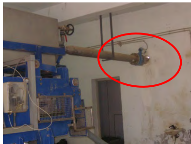
Photo 4-65 Débitmètre de boue d'alimentation de sécheur (Vue d'ensemble)
