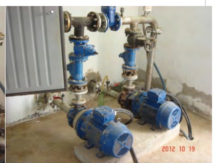
Photo 4-42 Pompe d'eau d'usine
