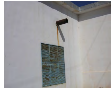
Photo 4-61 Bouche d'échappement (extérieur)
