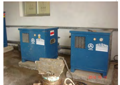
Photo 4-3 Soufflante de dégazage
