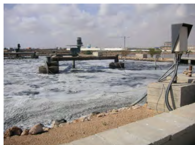
Photo 4-67 Aérateur (vue d'ensemble)
