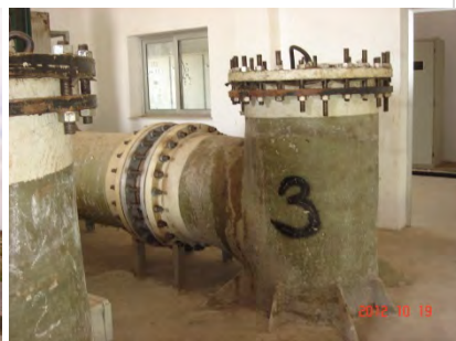
Photo 4-23 Pompe de retour de boue
