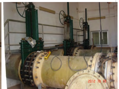
Photo 4-24 Tuyau de refoulement
