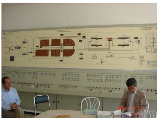
中央自動制御盤
