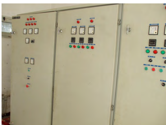
揚水ポンプ電気室配電盤
