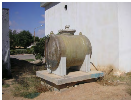
屋外燃料タンク
