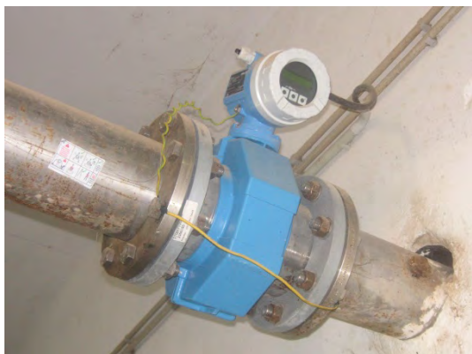
脱水供給汚泥流量計
