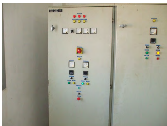
返送汚泥ポンプ棟電気室配電盤
