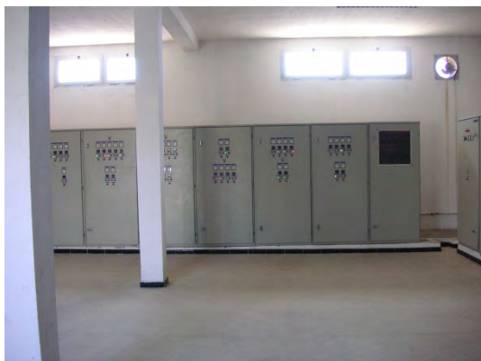
管理棟電気室配電盤
