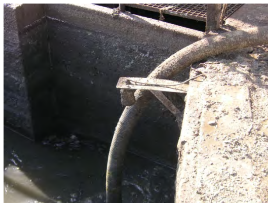
スクリーン上流側水位計
