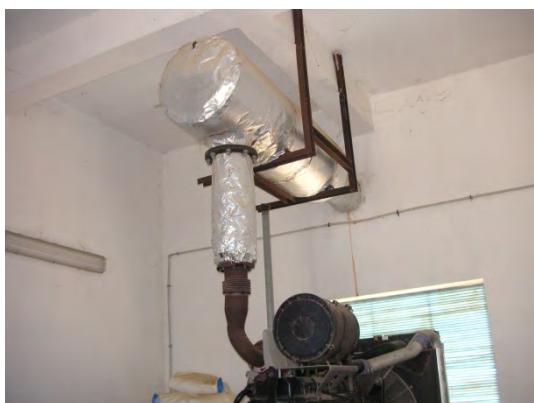
自家発電機排ガス消音器
