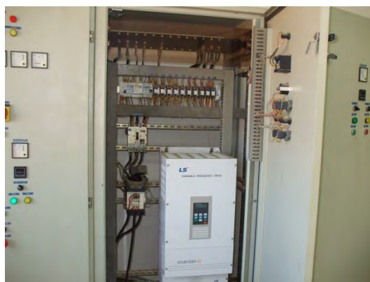
返送汚泥ポンプ棟電気室配電盤内部
