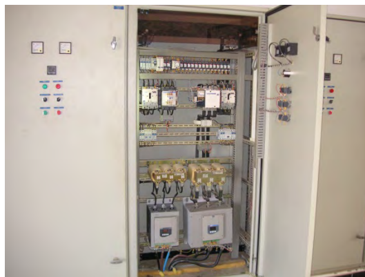
管理棟電気室配電盤内部
