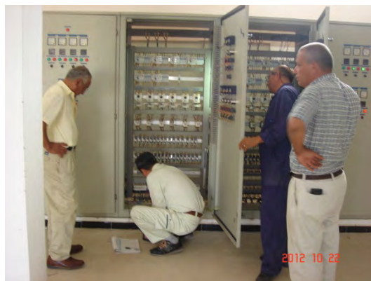
調査団絶縁測定調査
