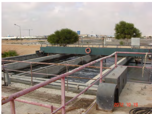
砂・油脂除去施設
