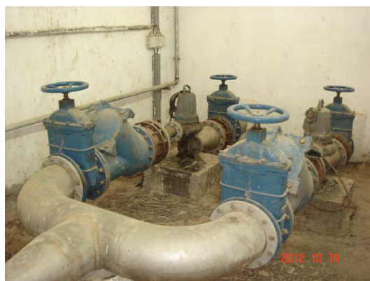
余剰汚泥ポンプ
