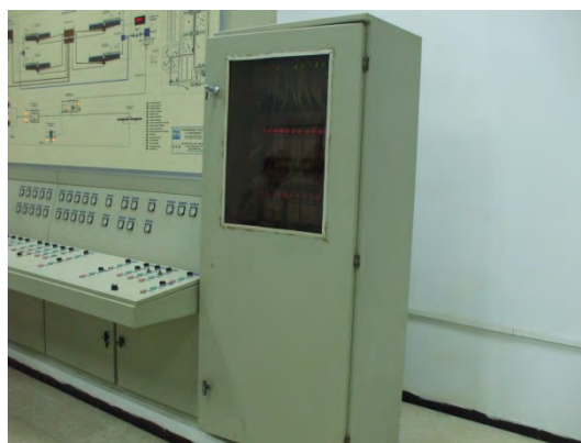
中央自動制御盤
