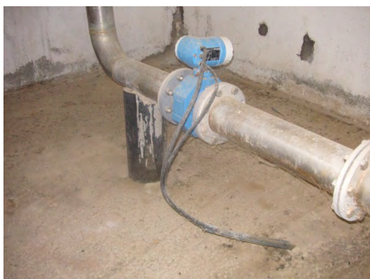
余剰汚泥流量計
