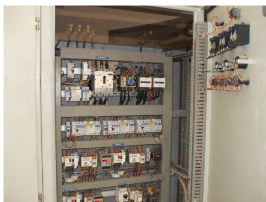
揚水ポンプ電気室配電盤内部
