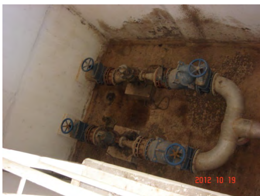
余剰汚泥ポンプ
