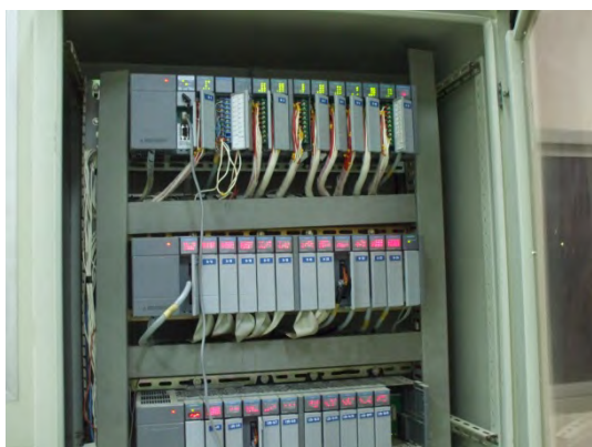
中央自動制御盤内部
