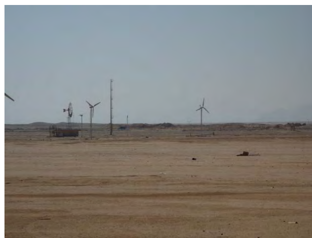
Photo2-2-4 Hurghada wind park (Ventis & Nordtank)
