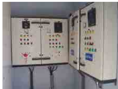
写真 3-3-6-5 電力用コンデンサ操作盤
