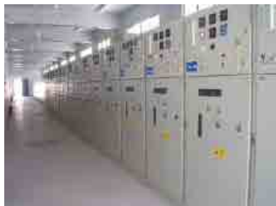
写真 3-3-6-4 中央ハルガダ変電所の開閉設備
