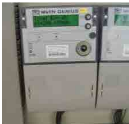
写真 3-3-6-2 66kV/22kV 二次側設置 電力量計
