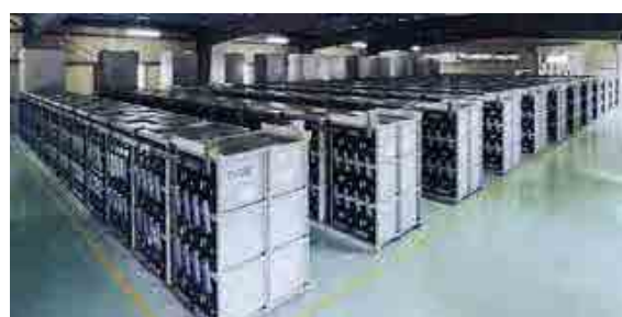
写真 3-3-9-2 負荷平準化(LL)用鉛蓄電池
