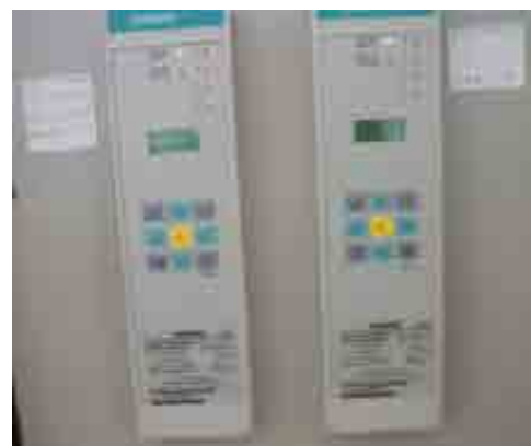
写真 3-3-6-3 22kV 配電線保護継電器
