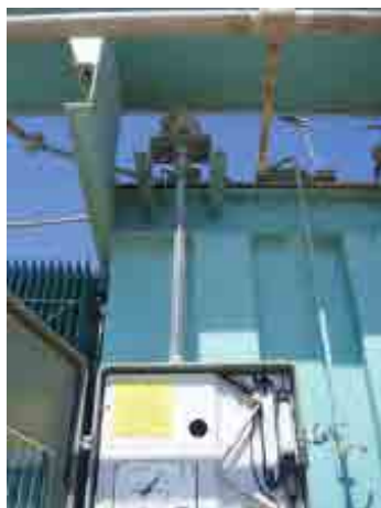
写真 3-3-6-2 66kV/22kV 変圧器 負荷時タップ切替装置
