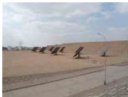
写真 2-2-13 カイロにおける 100kW 追尾式太陽光システム
