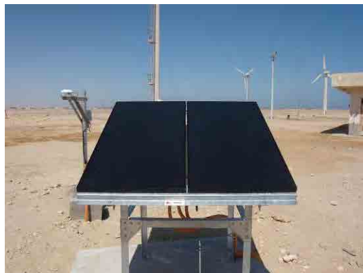
写真 3-2-1-3 太陽光発電モジュール
