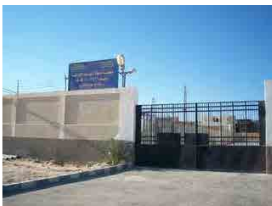
写真 3-1-2-3 送電会社所有 中央ハルガダ変電所
