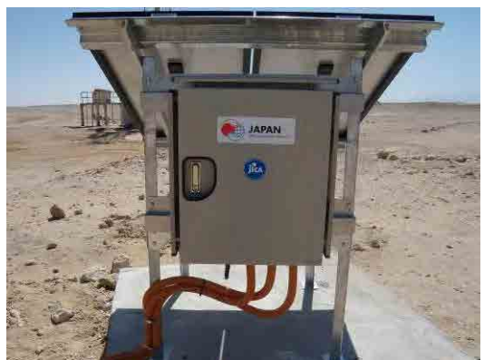
写真 3-2-1-6 屋外ボックス (データロガー、電流センサー)
