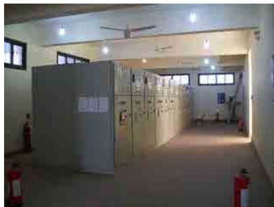
写真 3-1-2-2 配電所内 22kV 開閉設備
