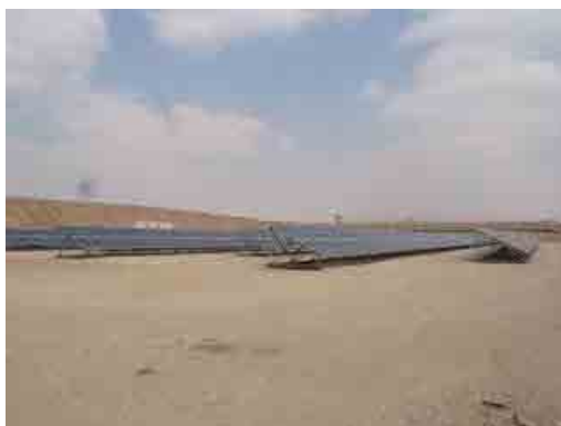
写真 2-2-12 カイロにおける 500kW 固定式太陽光発電システム
