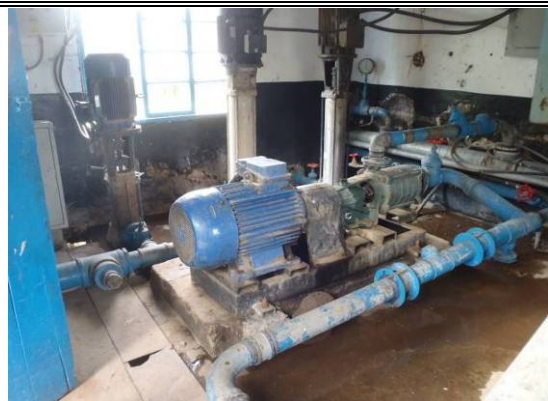
写真-9：中部浄水場 送水ポンプ（ポンプ室）
