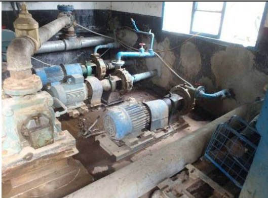
写真-3：中部浄水場 取水ポンプ（ポンプ室）
