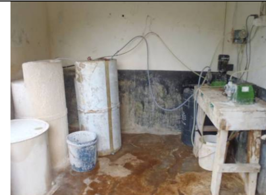
写真-4：中部浄水場 薬品注入室（凝集剤&塩素）
