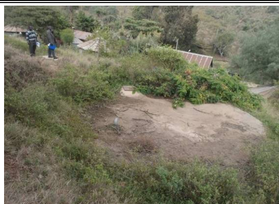
写真-11：中部浄水場 逆洗水槽 （フェーズ3施設, V=105m 3 ）
