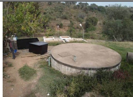
写真-10：中部浄水場 逆洗水槽 （フェーズ2施設, V=30m 3 ）
