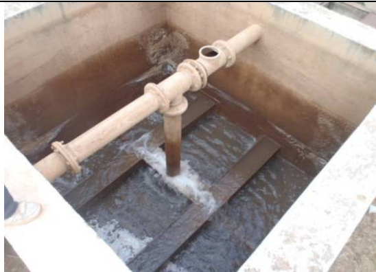
写真-7：中部浄水場 急速ろ過池（フェーズ3施設）
