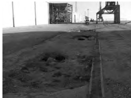
エプロン中央部の陥没状況
