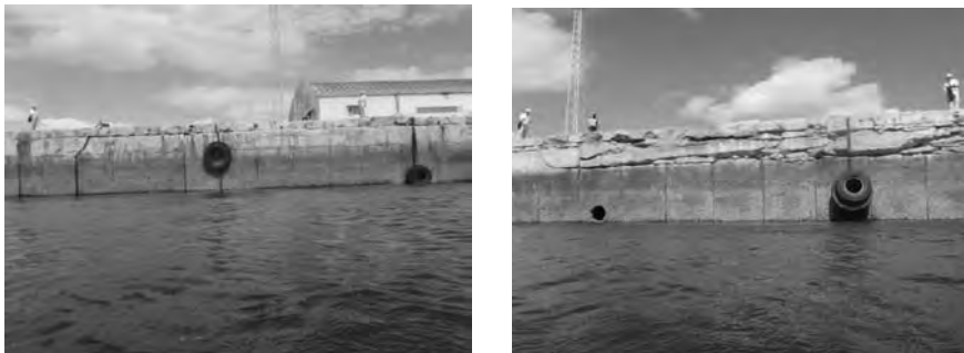
図 2.1.4-11 北埠頭の防舷材の設置状況
