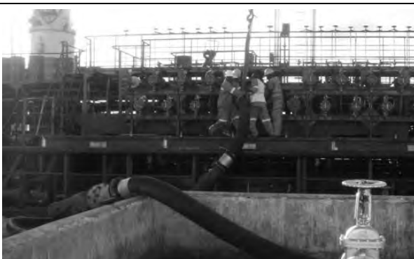
写真-16 オイル荷役状況
