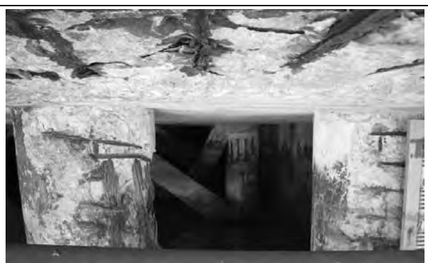
写真-30 南埠頭劣化状況
