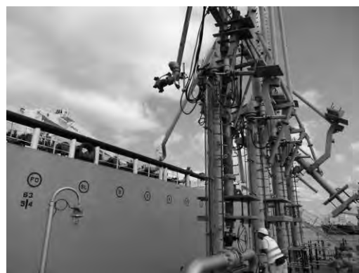
図 3.1.2-8 マプト港マトラ地区の荷役設備
