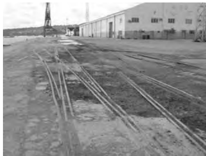
エプロン舗装の破損状況
