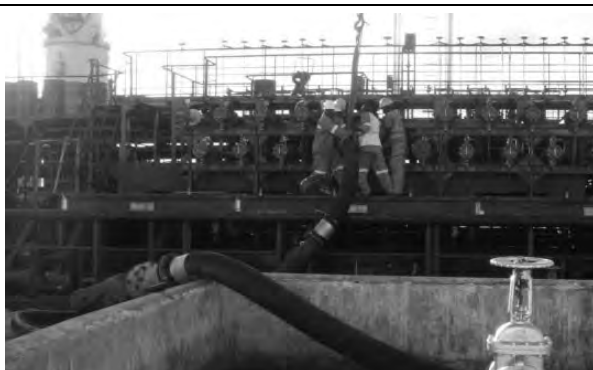
写真-16 オイル荷役状況
