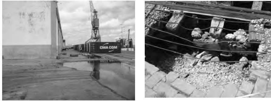
図 2.1.4-10 排水溝破損による地面陥没状況
