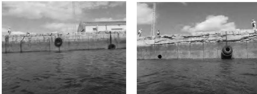
図 2.1.4-11 北埠頭の防舷材の設置状況
