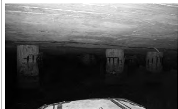
写真-31 南埠頭劣化状況
