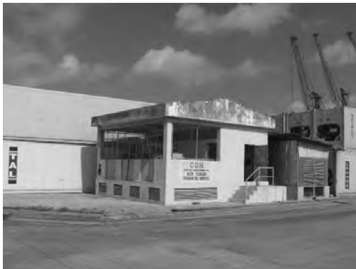
図 2.1.4-7 北埠頭2番倉庫背後にある変電所
