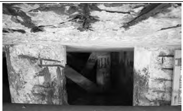
写真-30 南埠頭劣化状況
