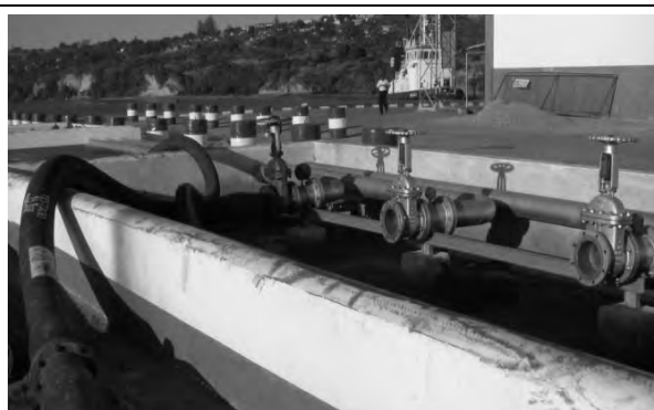
写真-14 既設オイル荷役設備
