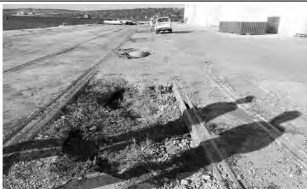
写真-5 北埠頭エプロン状況
