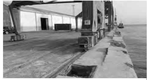
図 2.1.4-6 破損した既存の給水ピット
