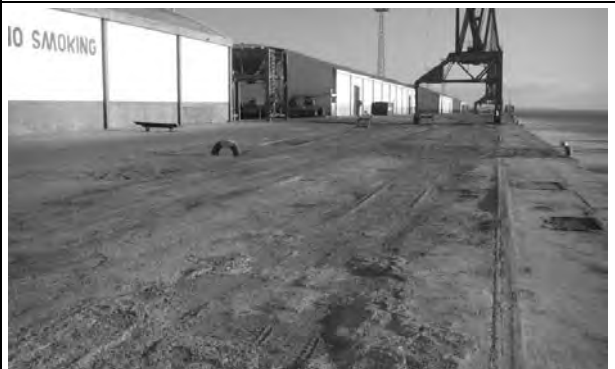
写真-6 北埠頭エプロン状況
