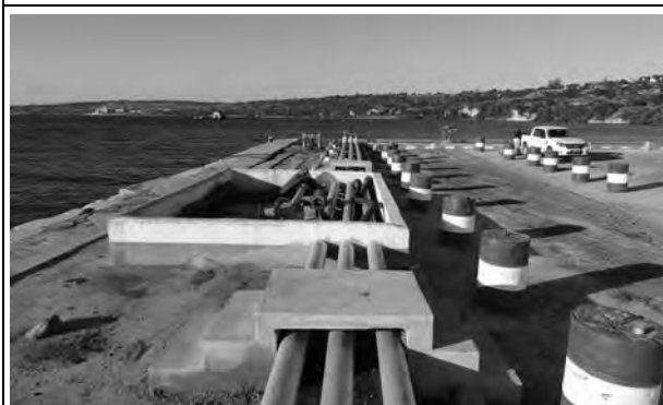
写真-13 既設オイル荷役設備
