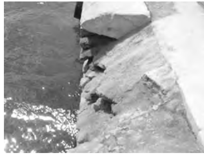
上部コンクリートブロック落下状況
