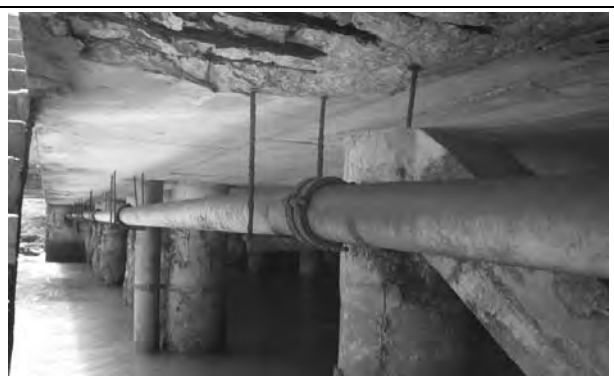
写真-32 南埠頭劣化状況
