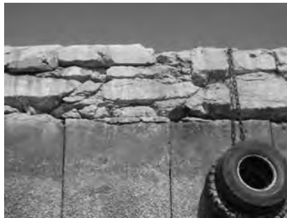
上部コンクリート劣化状況
