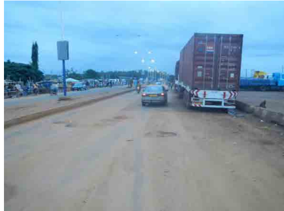
Route avec détérioration de la chaussée Route National 1 pres de terminal du Sahel, Togo
