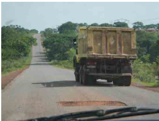
Bamfora-Niangoloko (1) ポットホールの発生
