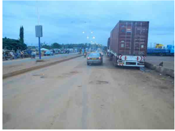
舗装の劣化が激しい区間 Sahel ターミナル周辺の国道1号線、トーゴ
