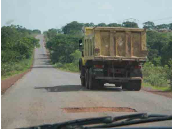
ポットホールが出来た道路 Bamfora-Niangoloko、コートジボワール
