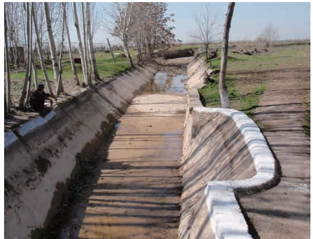
Inter-farm Canal から分水後の Internal Canal
