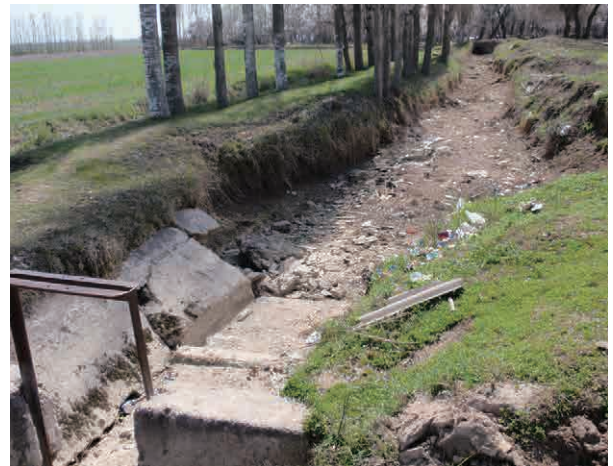
Internal canal の分水施設は分水管理が行える状況ではない。
