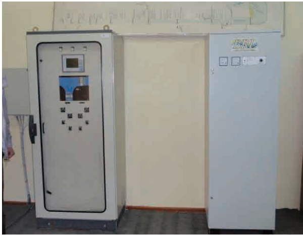
South Mizachul Main Canal のゲート操作盤
