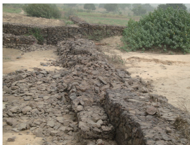
修繕が必要な洪水堰（バクソモバ）
