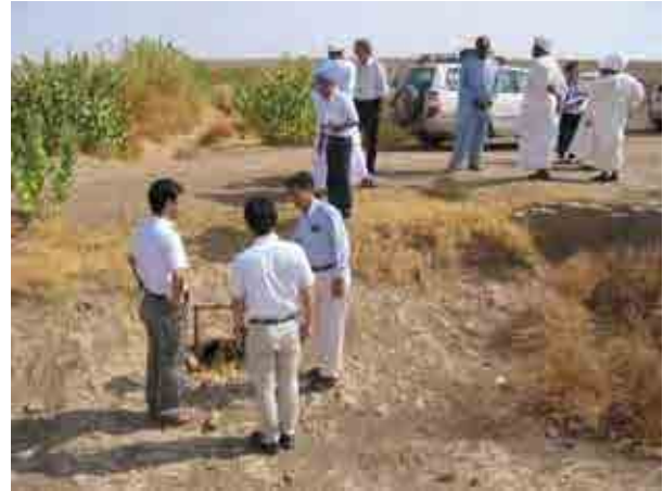
スキーム：Korba 標題：3次用水路への分水工（破損） 日付：2010年8月27日
