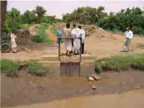
スキーム：Kitiab 標題：メイン用水路（マイナー用水路への分水工 / 破損） 日付：2010年9月2日
