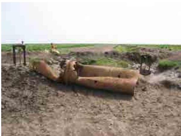
スキーム：New Halfa 標題：3次用水路への分水工パイプ（老朽化のため撤去） 日付：2010年8月18日
