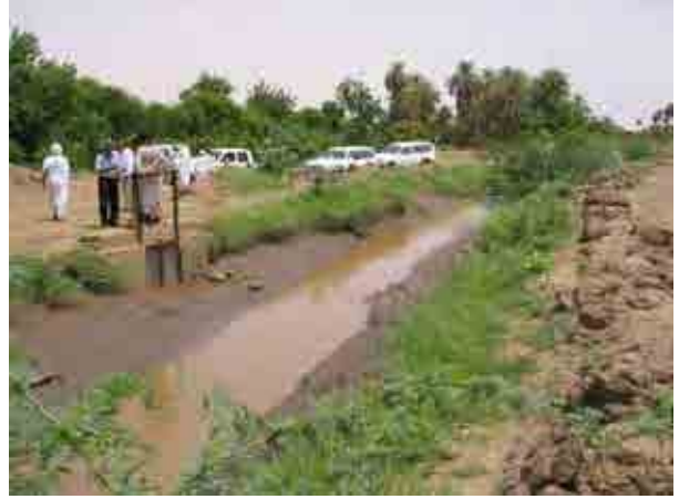
スキーム：Kitiab 標題：メイン用水路（マイナー用水路への分水工 / 破損） 日付：2010年9月2日
