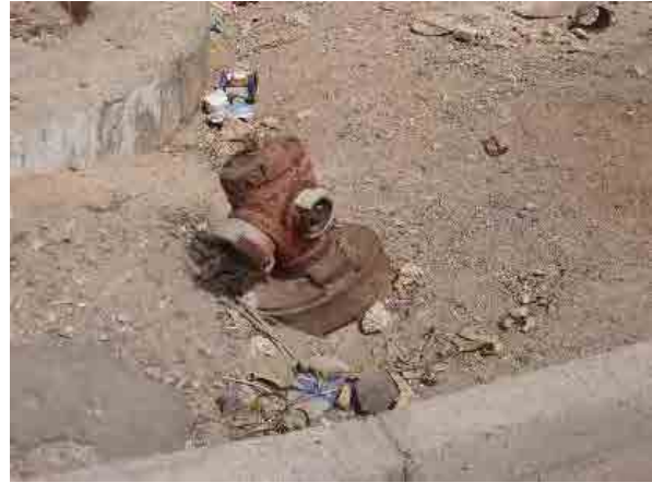
Une bouche d'incendie hors d'usage. La coupure d'eau étant fréquente, on ne peut pas compter sur les bouches fonctionnelles.
