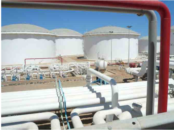
Un complexe pour les matières dangereuses. 370.000 kilo litres d'essence transportés par des camions citernes est stockés dans les 31 réservoirs extérieurs.
