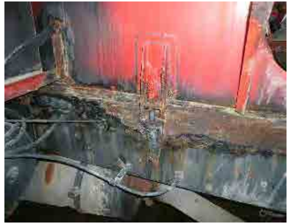
水槽車の腐食状況。車体強度上重要なシャシフレームにもかなり錆が発生している。
