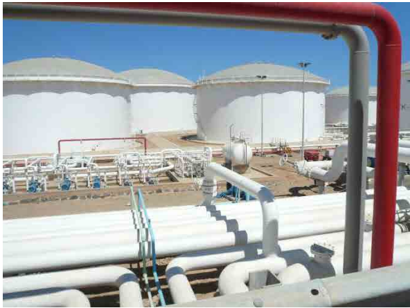
大規模危険物施設。屋外タンク 31 基、37 万 KL を貯蔵する。タンクローリーで各地へ輸送している。
