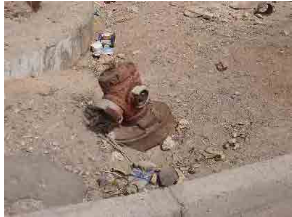
故障消火栓。故障していない消火栓も断水が頻繁にあり、消防水利として期待できない。
