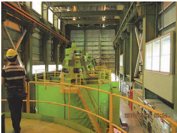
Photo-3 ワイロア発電所 56MW 発電中 5月30日 午後1時30分
