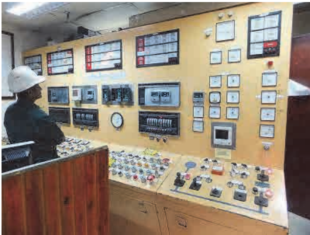
写真 4-7 発電設備制御盤
