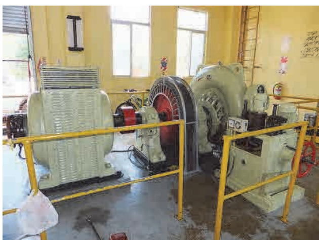
水車・発電機
