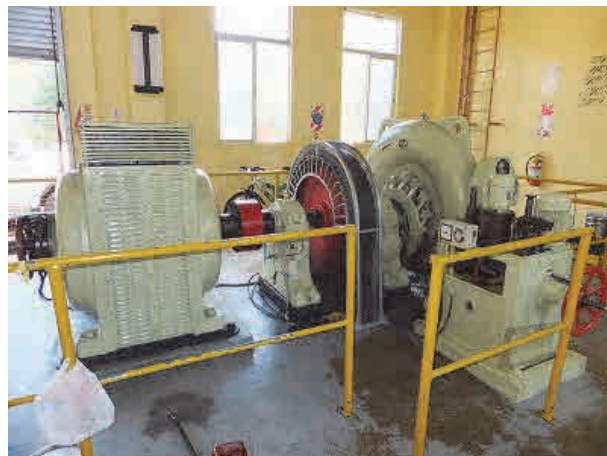
写真5-4 水車・発電機
