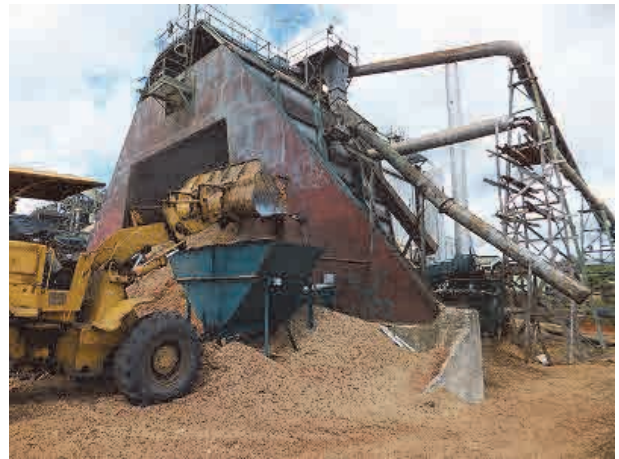
写真 4-8 木材燃料投入口
