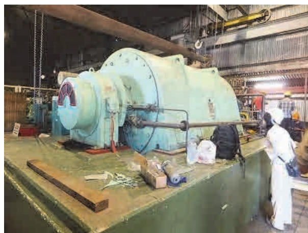
写真4-2 コジェネ用発電機
