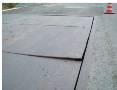
床板がめくれているが、機能上問題ないとしている。
