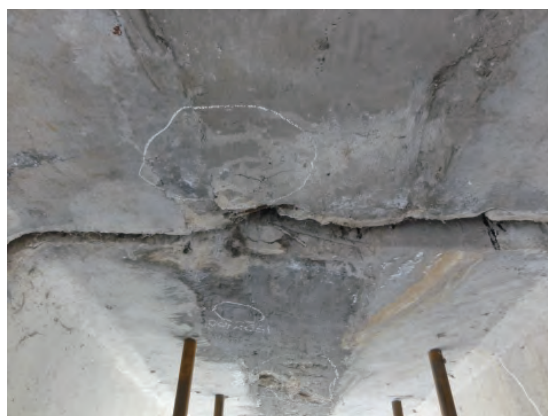
写真－ 27 No. 6 橋 床版下面 老朽化、漏水によるスポーリング、鉄筋腐食
