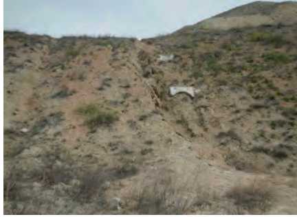
写真－ 23 D3 洗堀状況
