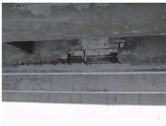
写真－ 32 No. 13 橋 桁 コンクリートの剥落、鉄筋露出・腐食
