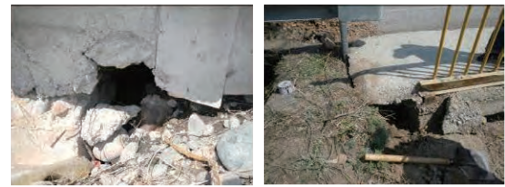
写真－ 22 橋台背面沈下 (沈下要因 D) 路面状況及び橋台周辺の空隙
