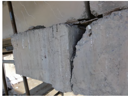
写真－ 39 No. 6 橋 P2 橋脚間詰コンクリートとの剥がれ（側部から）
