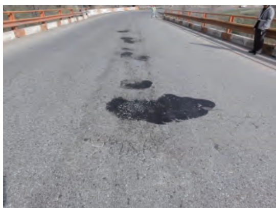
写真－ 28 No. 4 橋 車道中央部 床版継ぎ目部 アスファルトによる補修後
