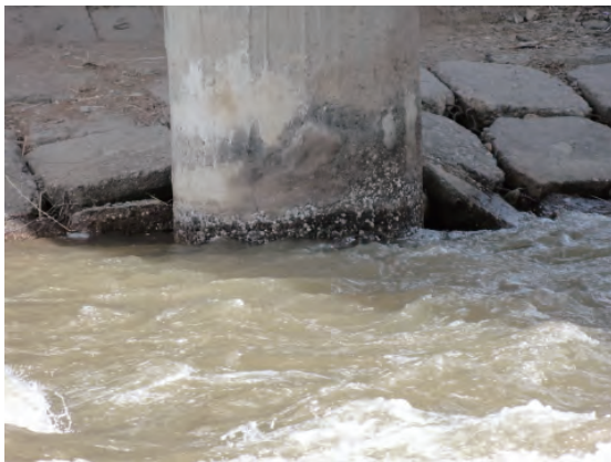
写真－ 40 No. 6 橋 P1 橋脚洗掘を受けている
