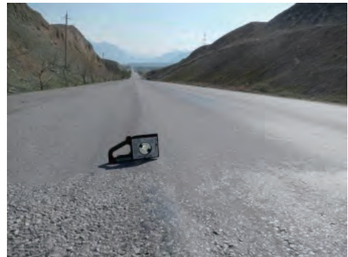
写真－ 25 D19 わだち掘れ状況
