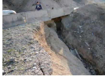
写真－ 24 S2 洗堀状況
