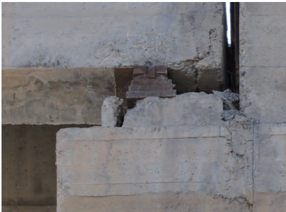
写真－ 36 No. 10 橋 支承台座コンクリート 剥落している
