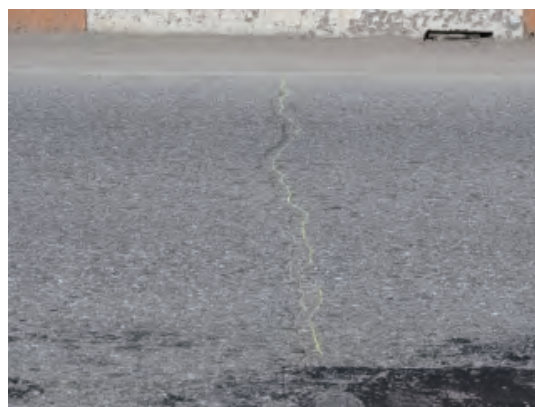
写真－ 29 No. 4 橋 横断方向ひび割れ 床版の継ぎ目部
