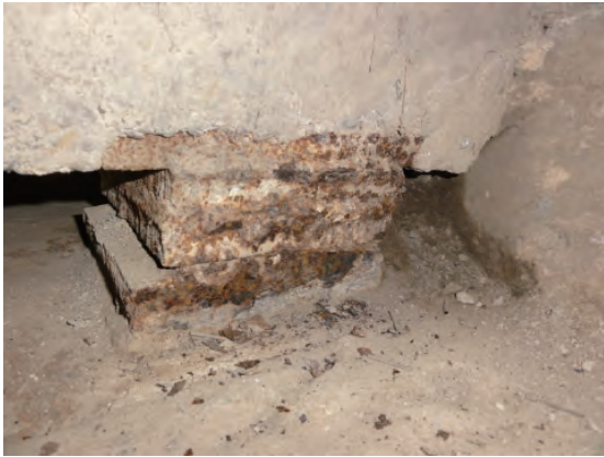
写真－ 34 No. 17 橋 鋼製支承 腐食が進んでいる
