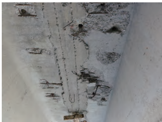
写真－ 30 No. 10 橋 桁フランジ下面 フランジ上部から貫通した鉄筋ボルト
