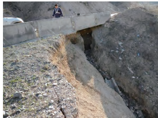
写真－ 2 S2 (KP357+526 洗堀箇所)
