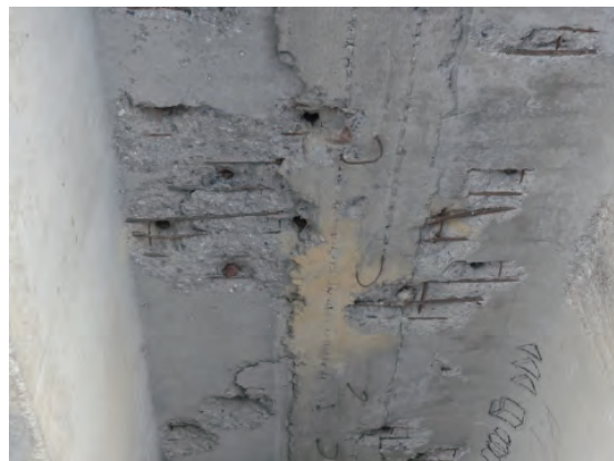
写真－ 31 No. 13 橋 桁フランジ下面 フランジ上部から貫通した鉄筋ボルト
