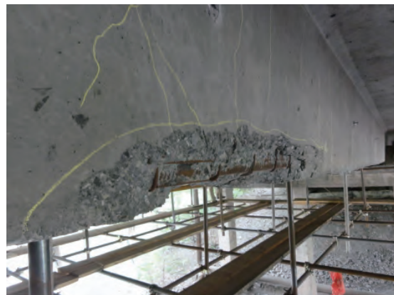
写真－ 33 No. 17 橋 桁 コンクリートの剥落、鉄筋露出・腐食、ひび割れ
