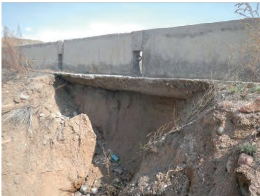
写真－ 1 S1 (KP290+752 洗堀箇所)
