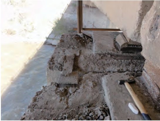
写真－ 38 No. 6 橋 P2 橋脚間詰コンクリートとの剥がれ（上部から）
