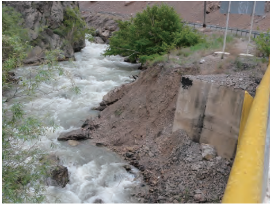
写真－ 42 No. 14 橋護岸の崩壊
