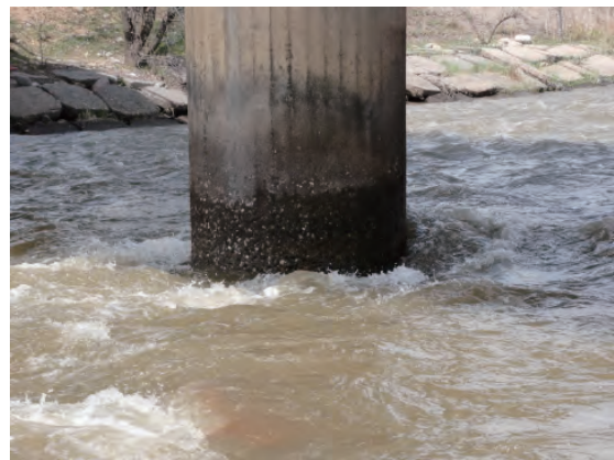
写真－ 41 No. 6 橋 P2 橋脚洗掘を受けている
