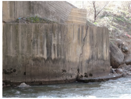
写真－ 43 No. 4 橋 コンクリート護岸 大きなひび割れ
