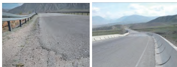
写真-19 路床または路体の支持力不足 (D12, D23)
