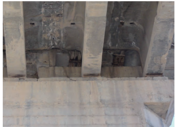
写真－ 37 No. 10 橋 支承台座コンクリート ひび割れが進行している
