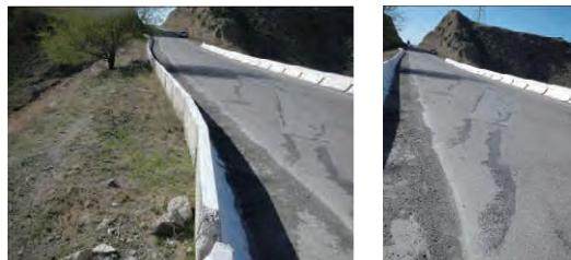
写真-20 盛土スベリ破壊によるクラック(D32)
