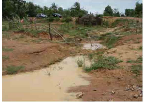
Tumnap Lok 貯水池の取水工
