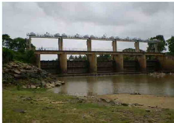
Roleang Chrey 頭首工 (下流側より撮影)
