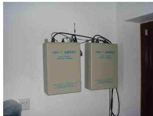
雨量観測データ伝送装置
