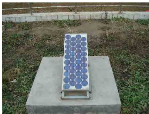
電源の太陽電池パネル
