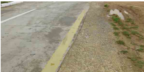
路肩部は、本線部と別施工となっている損傷は本線部より激しくなっている
