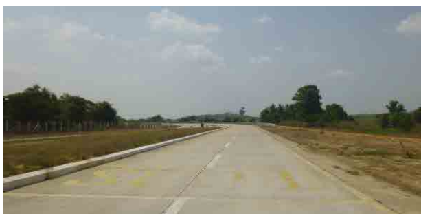
線形の悪い区間では、80km/h規制となっている 「SLOW」の警戒レーンマークが施工されている
