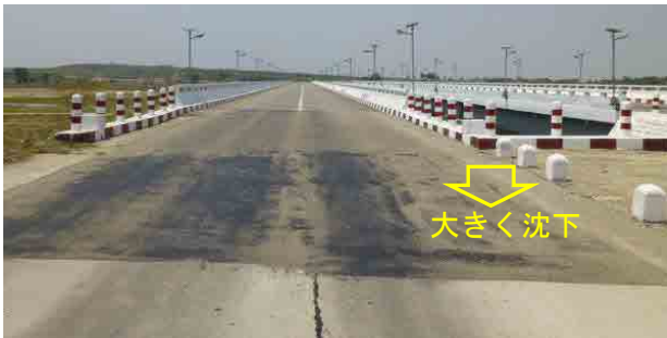
橋梁の裏込め部や、横断構造物の埋設箇所では路面の沈下が生じている
