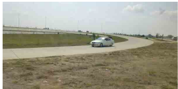
ICランプでは、安全施設が全くない箇所あり ネピドーのICランプ (夜間視認性は非常に悪い)
