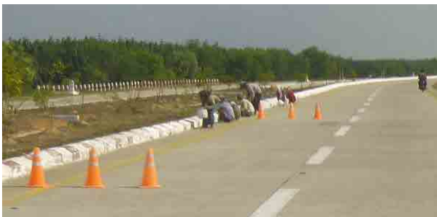
中央分離帯側の縁石の塗装工事 非常に簡易な車線規制となっている
