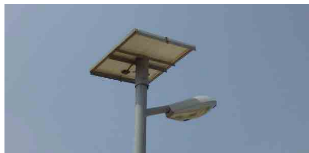
橋梁上や主要ICのみに照明が設置されている 照明には、太陽電池が採用されている
