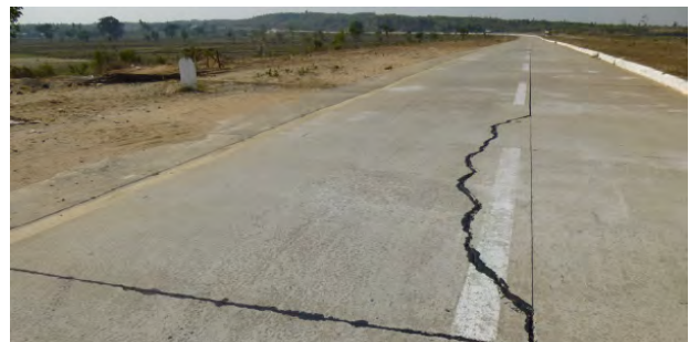
縦断方向のクラックも多数、観察された
