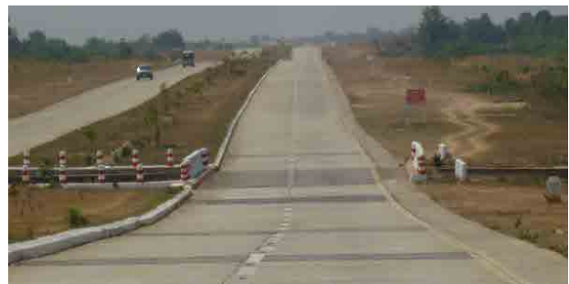
サグ部は、損傷の激しい箇所となっているCr舗装板が不当沈下を起こしている
