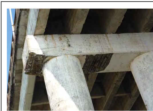
写真 2.6 橋脚部の塩害
