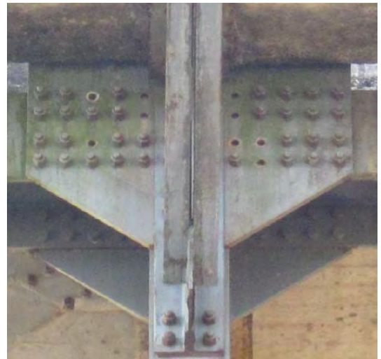
写真 3.5 高力ボルト欠落の例 (Pathein 橋)
