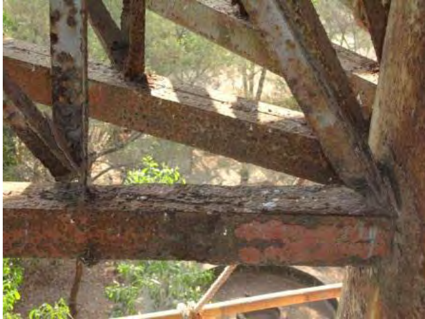
写真 3.6 Myaungmya 橋の腐食状況(塗替前)
