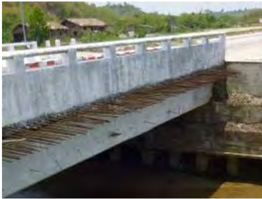
写真 3.12 拡幅に必要な床版鉄筋の錆が発生
