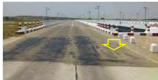
写真 3.21 裏込め部での不等沈下
