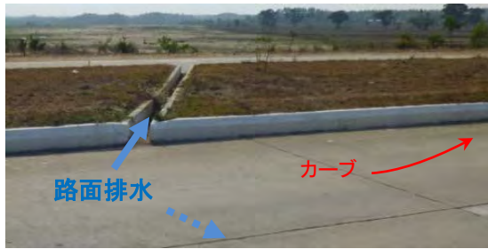
写真 3.18 中央分離帯の横断排水施設
