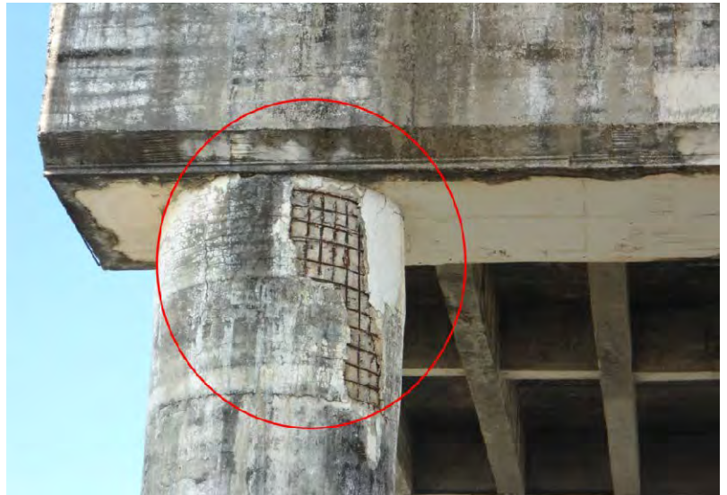
写真 3.3 塩害の例 (Min Chaung 橋)
