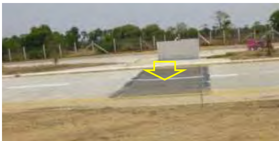
写真 3.20 ボックスカルバート部の沈下
