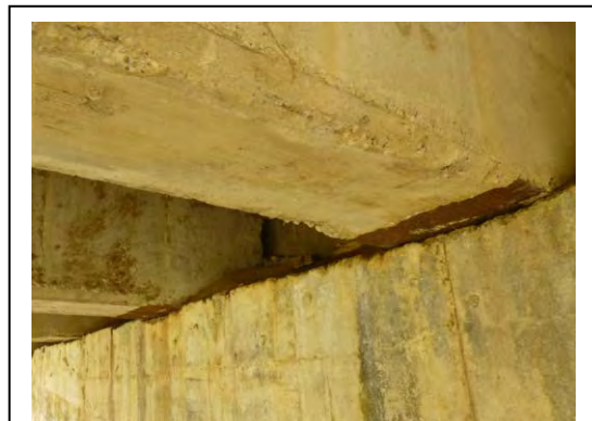
写真 2.7 コンクリート桁下のジャンカ
