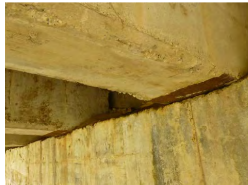
写真-3 コンクリート桁下のジャンカ
