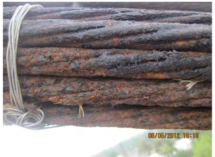
写真 3.11 Myaungmya 橋のメインケーブル損傷状況
