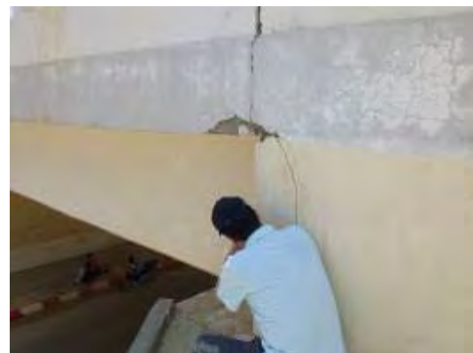
写真 3.15 橋台の転倒に伴う、橋台、桁のクラック
