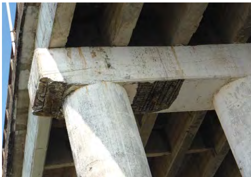
写真-2 橋脚部の塩害
