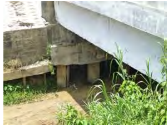
写真 3.13 橋台、ブロック張り基礎の洗掘
