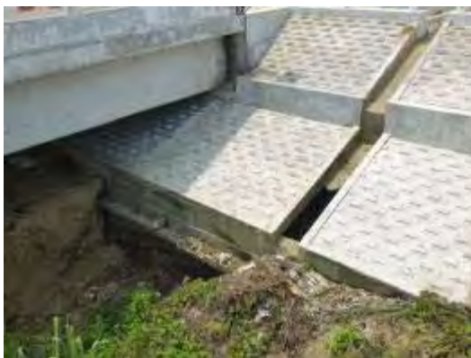
写真 3.14 排水不良に伴うブロック張背面の抜け
