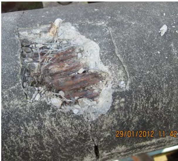
写真 3.10 Myaungmya 橋のメインケーブル腐食状況
