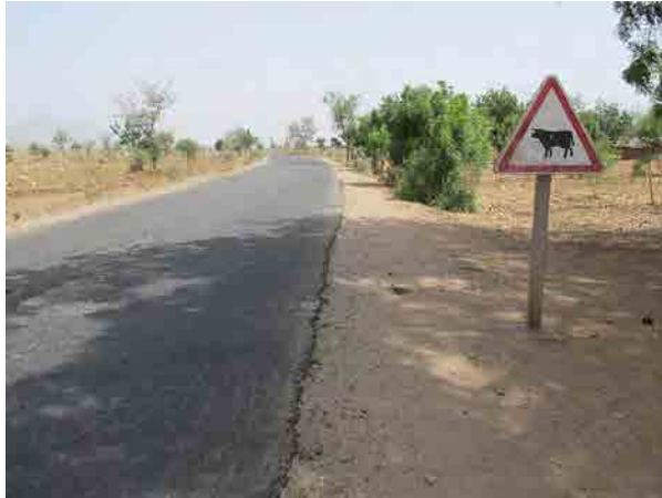
【写真-18 道路状況】極北州マルア市から西へ延びる州道2号線、舗装が荒れている
