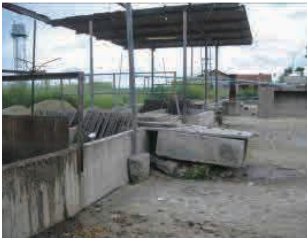
33. ゼンゲザ下水処理場（旧） - 流入部
