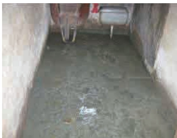
22. 汚物が逆流したトイレ
