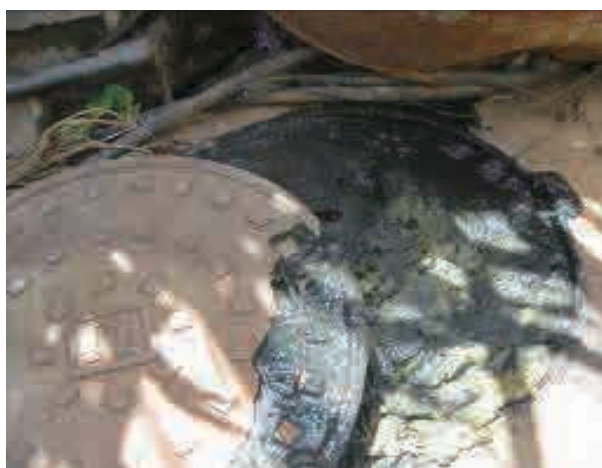
23. 汚泥で満杯になったマンホール
