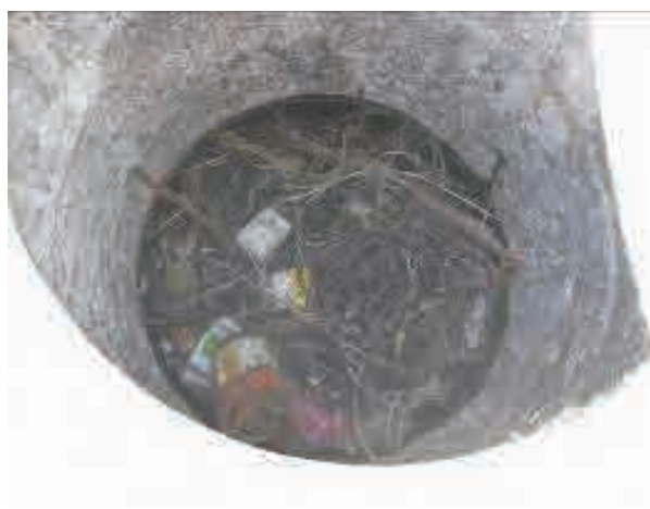
24. マンホール内に堆積したゴミ
