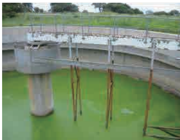
28. ゼンゲザ下水処理場（最初沈殿池）
