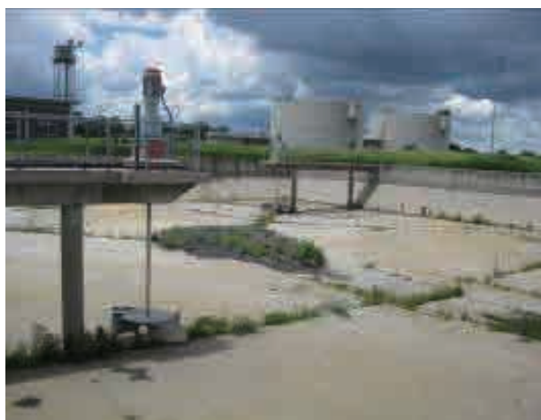
29. ゼンゲザ下水処理場 - 流量調整池
