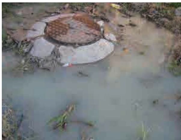
25. マンホールからの汚水の流出
