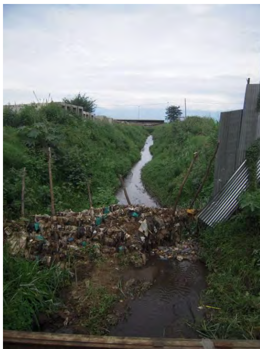
Ordures piégées dans le canal (situé à l'extérieur du port) lors des inondations antérieures (Photo prise en mars 2012).
