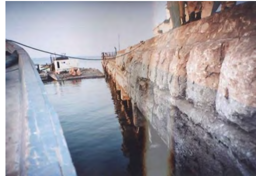
Photo 3.21 : Plate-forme et piliers en béton endommagés au port de Kalemie
