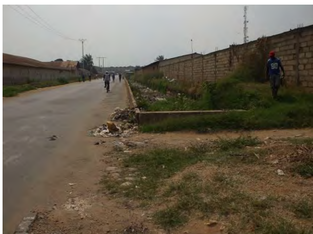
Photo 3.2 : Canal de Buyenzi sur la chaussée adjacente
