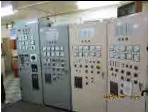
発電機操作盤
