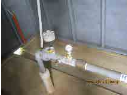
水中ポンプ用配管
