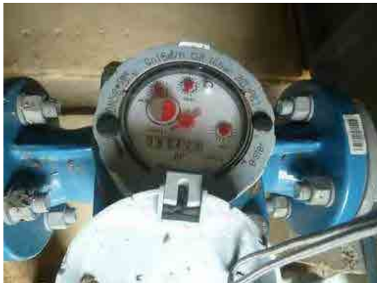
水中ポンプに設置されている流量計
