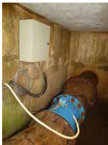
使用されていない 電磁流量計
