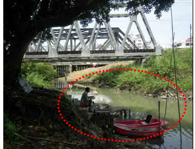
クラマン水門建設予定地。水門3門(HWL+6.0m MSL)を既存鉄道橋の手前に設置する。水門から鉄道橋盛土まで波形コンクリート矢板または現場打コンクリート壁を用いた防水壁整備(天端標高+7.0m MSL)を行う。
