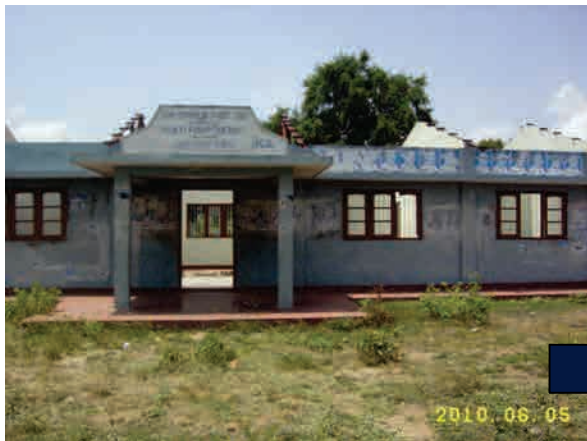
コミュニティ・コントラクトによって復旧され る前の多目的ホール (パーリアール村)
