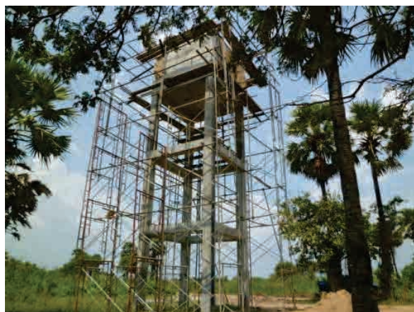
村落給水システム用の高架タンク (ウィラッティクラム村)
