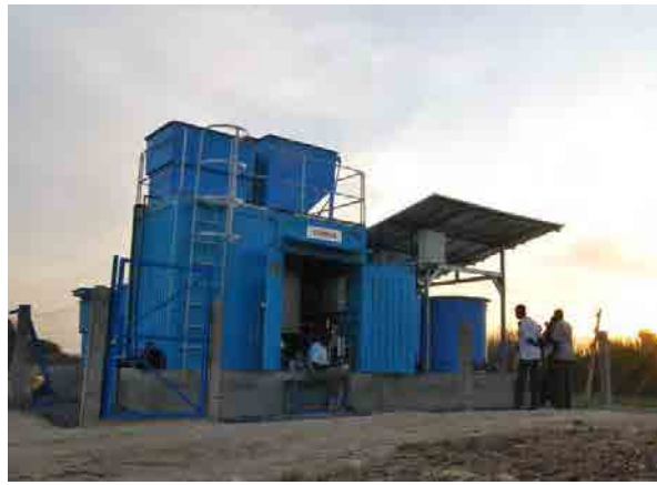
パイロット事業にて設置したヤマハ浄水装置 (YCW-008)
