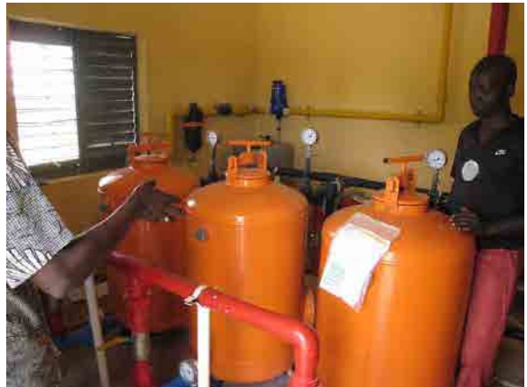
サンルイ州 Ndialakar Wolf 村の浄水施設 急速濾過機
