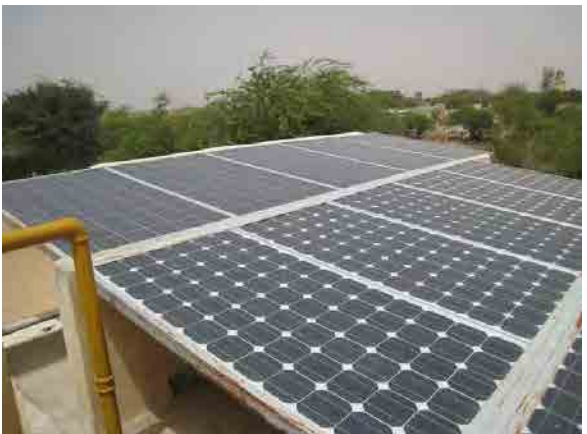
サンルイ州 Ndialakar Wolf 村の浄水施設 太陽光パネル
