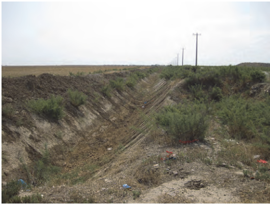
未整備の水路
