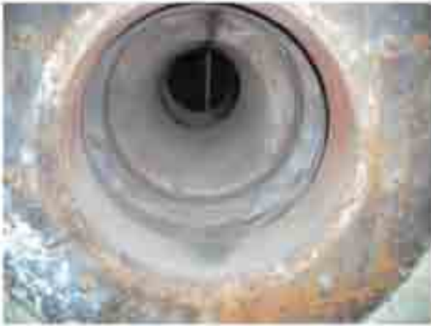
220t/h ボイラ バーナ (開放中)
