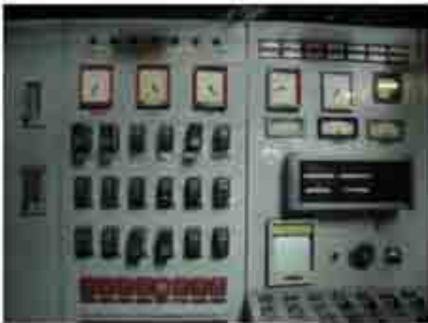
75t/h ボイラ旧式表示盤
