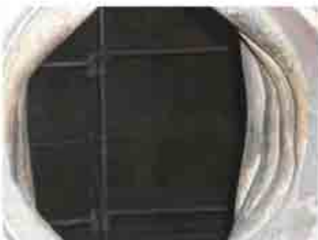
220t/h ボイラの内
