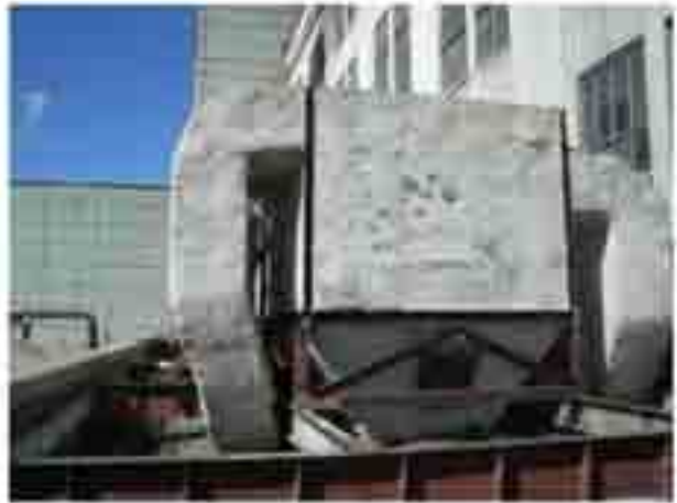
35t/h ボイラ サイクロン
