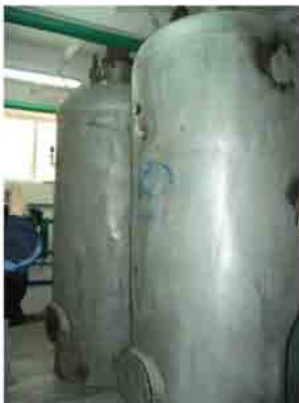
モンゴル製 (HP30J) ボイラ
