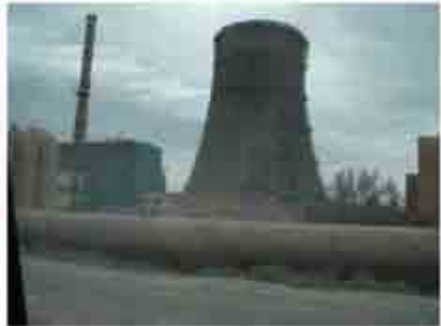
冷却塔 (手前は熱水供給パイプライン)
