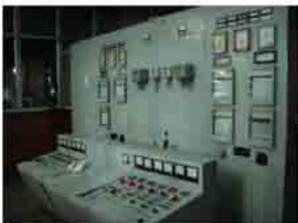
350kV ボイラ制御盤
