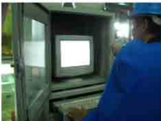
環境データ収録装置
