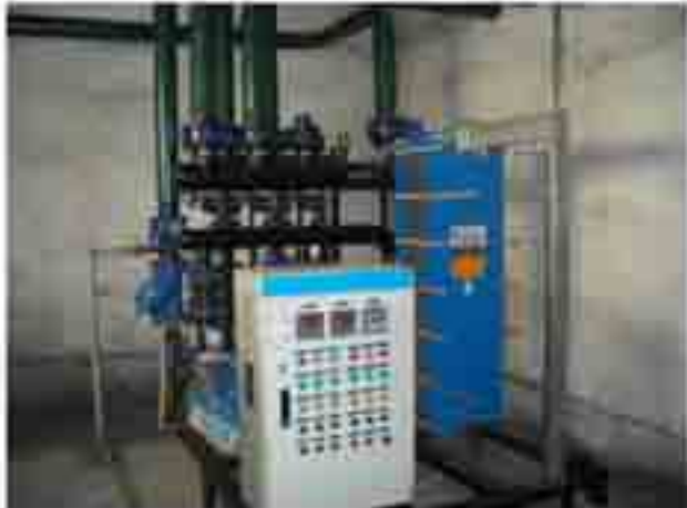
温水制御装置
