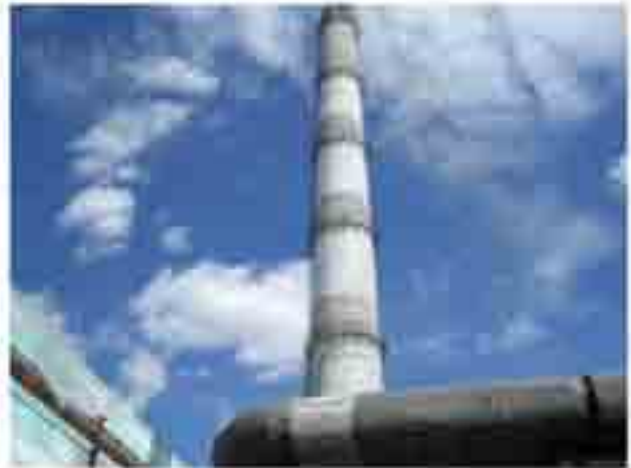
75t/h ボイラ用煙突
