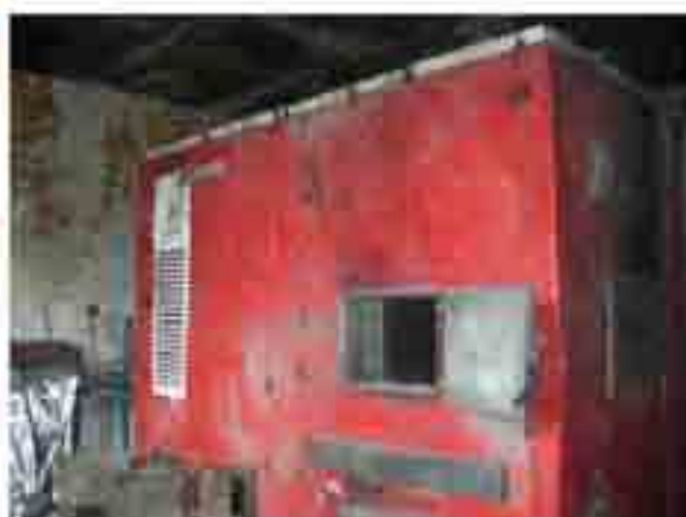
中川製 (CANG)ボイラ
