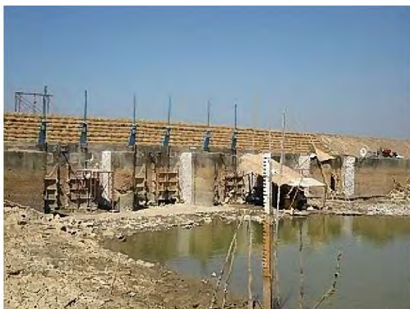
【サイクロン「ナルギス」による損傷状況】
