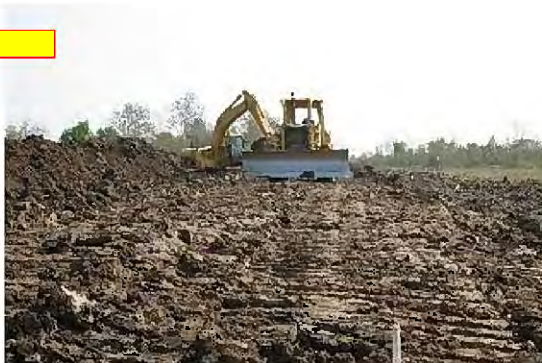
ブルドーザーによる撤出し、転圧状況 (バックホーとブルドーザーのペアで作業している)
