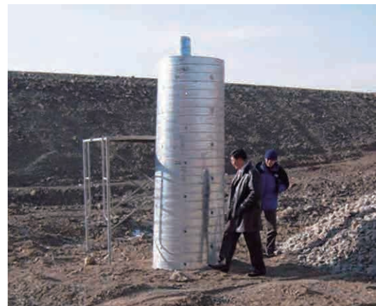
設置されたガス抜き管
