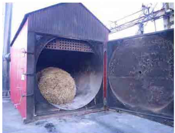
Moldagrotehnica社工場併設ボイラー
