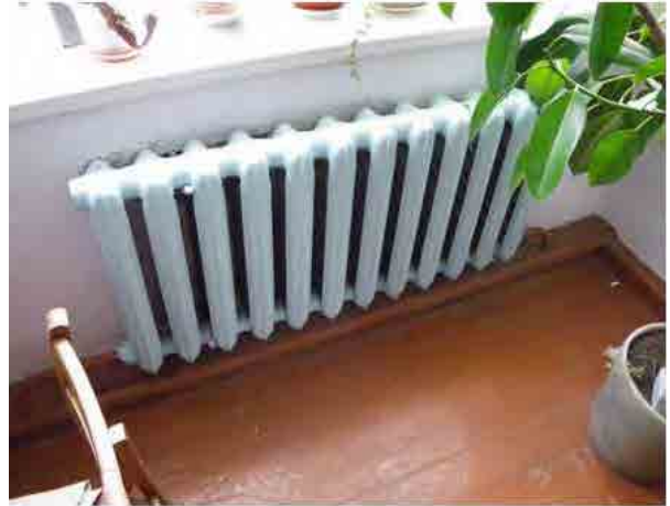
暖房設備 （Hirtopul Mare村）
