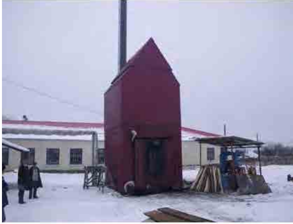
小学校設置ボイラー (Glodeni県Viisoara村)
