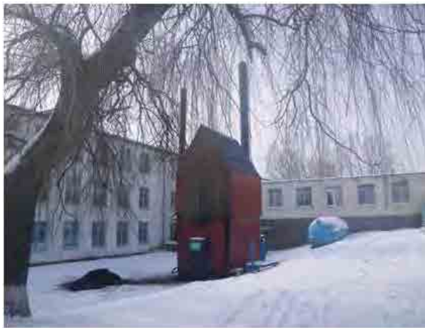
小学校設置ボイラー (Chiscareni村)
