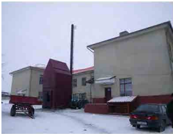
小学校設置ボイラー (Taraclia村)
