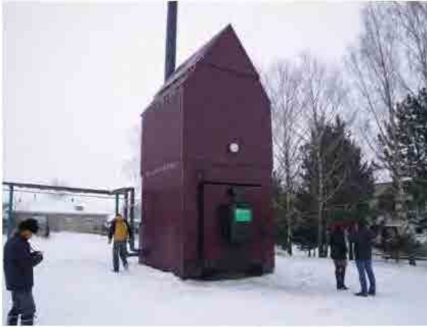
小学校設置ボイラー (Burlanesti村)
