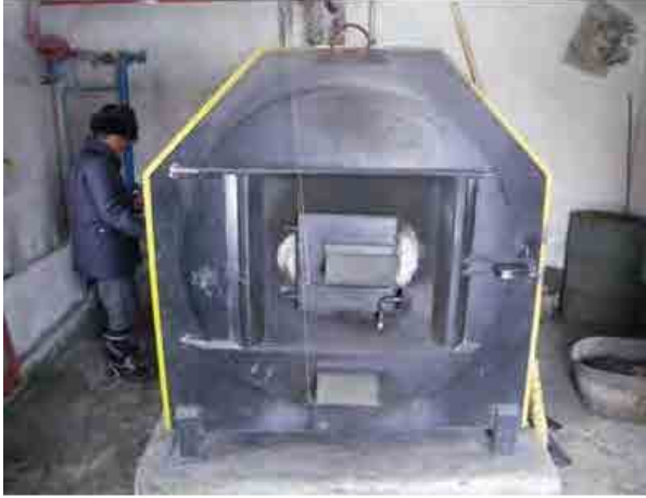
児童施設設置ボイラー (Volintiri村)
