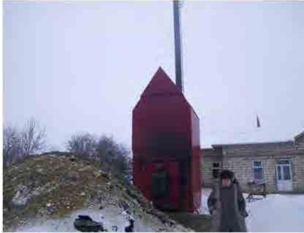
村設置ボイラー (Bogheni Noi村)
